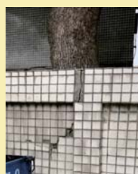
施工前 老樹擠壓宿舍圍牆 造成牆裂
